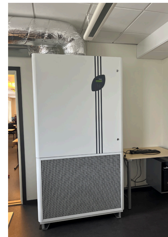
Ventilationsaggregat i ett klassrum
