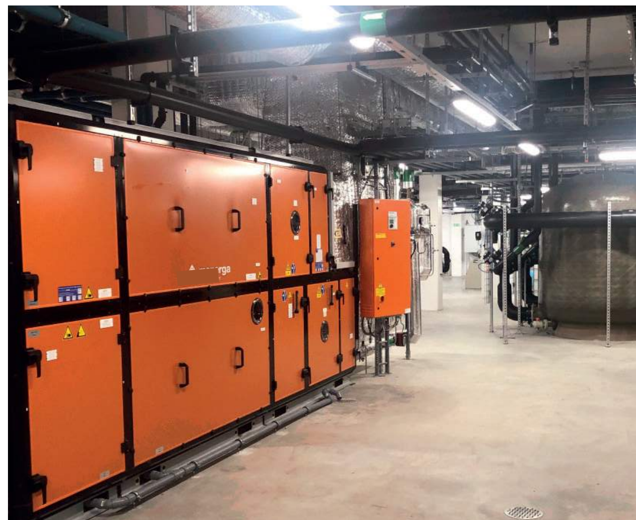
Referensbild: exempel på luftbehandlingsaggregat från en simhallsanläggning
