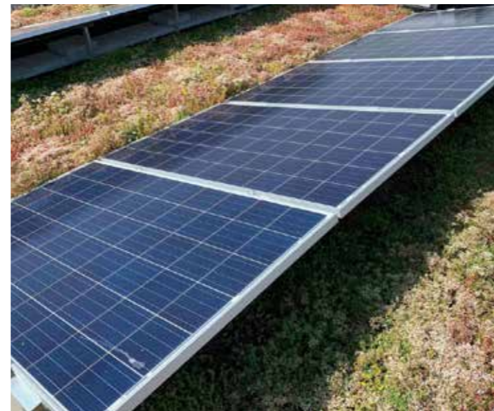
Bild: Solceller tillsammans med sedumtak. Foto sopraema.se
