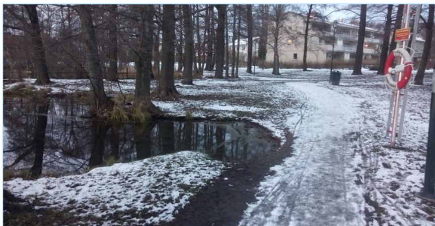
Figur 14. Erosion intill parkväg på Stockholms sida av Långsjön. Foto: Sofia Spaak.
