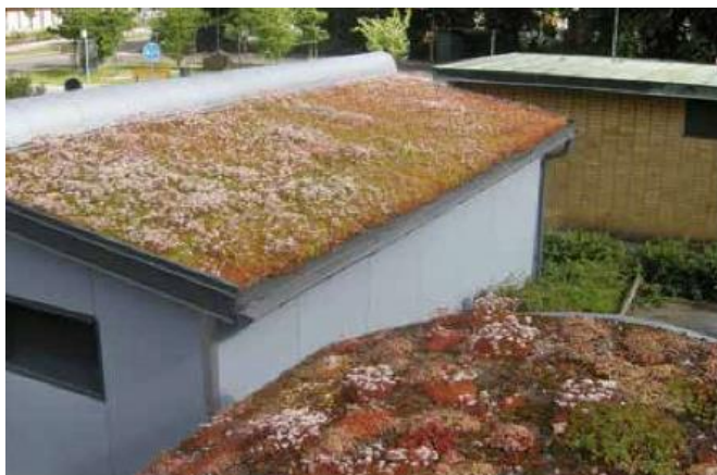
Figur 23. Grönt tak (sedum och mossa). Bild hämtad från Grönatakhandboken 32 .
