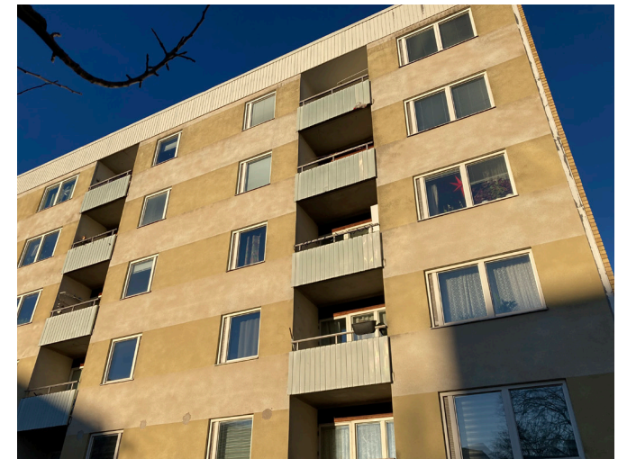
Fasaderna har en rytmisk uppbyggnad som bygger på repetition. Balkongerna har en tidstypisk utformning med den bakomvarande väggen klädd i panel.
