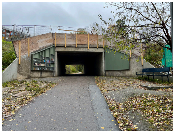
Gångtunnel under Visättravägen som fungerar som en entré för gående som kommer från Flemingsberg
