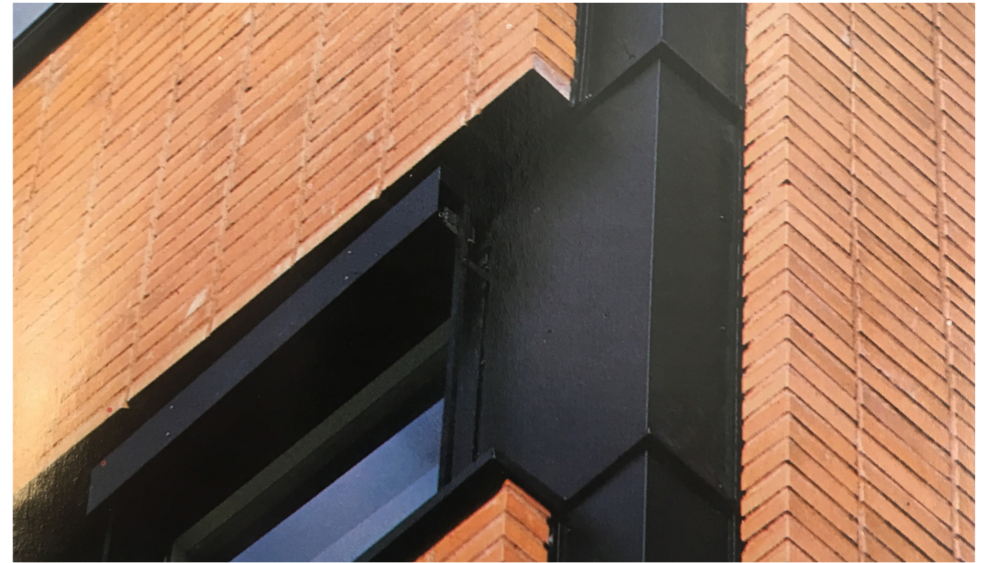
Fasaderna utfördes av ljus fasadtegel med rosa fogar. Ur LM Ericsson, Berg Arkitektkontor, Trycksak, KB.
