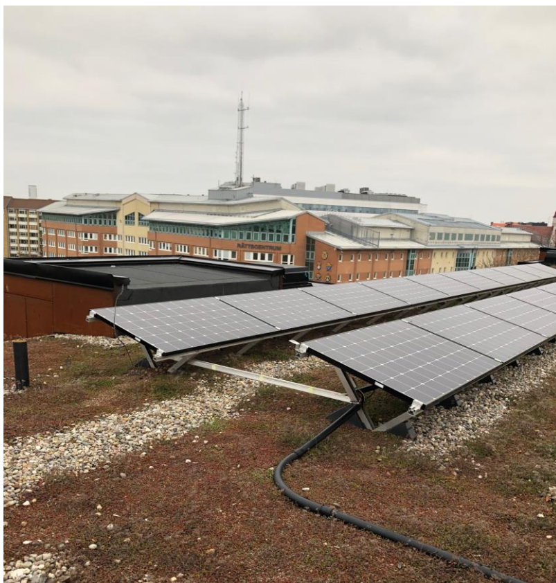
Figur 13. Vegetationsklätt tak med solceller i Malmö. Foto: Camilla Hedell
