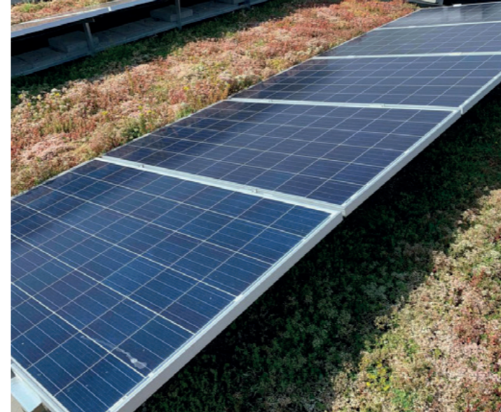
Bild: Solceller tillsammans med sedumtak. Foto sopraema.se
